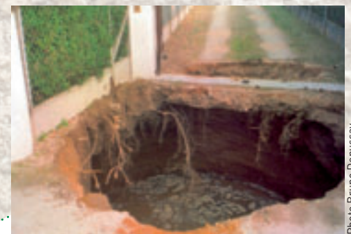
Un fontis à Saint-Denis-en-Val, de plus de 5 m de diamètre
